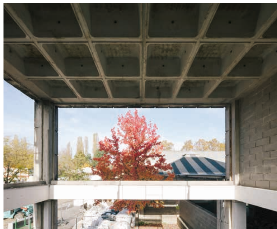
Durant le chantier, le bâtiment a été entièrement désossé; et les plafonds à caissons, ouverts.
